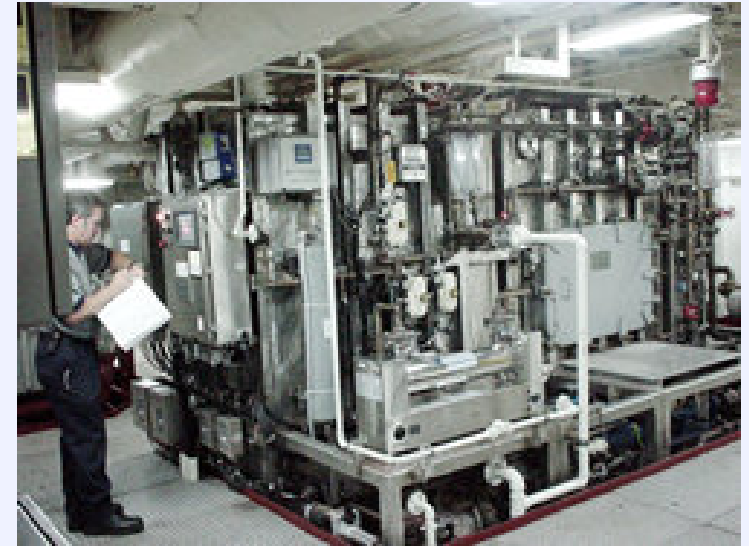
Grauwasseranlage an Bord eines Schiffs
