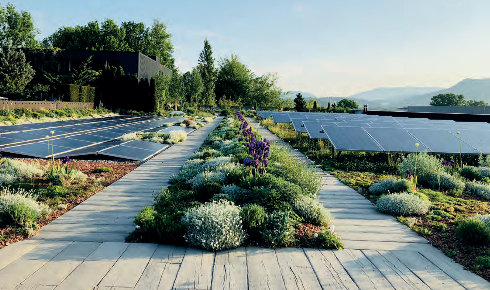
Grüne Dächer im Einklang mit grünem Strom: Die Kombination von Solarpaneelen und Dachbegrünung ist inzwischen Stand der Technik. (© Contec AG)
